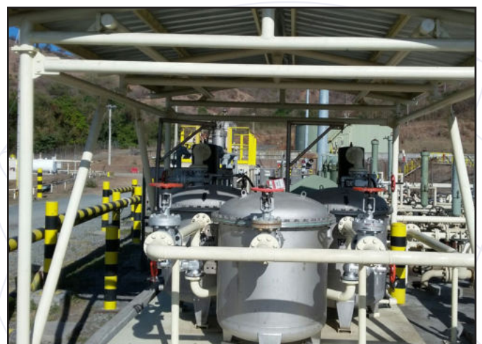
Einsatz in einem Dieseltanklager für Pertamina/Indonesien. Deployment in a Diesel storage facility for Pertamina/Indonesia.
